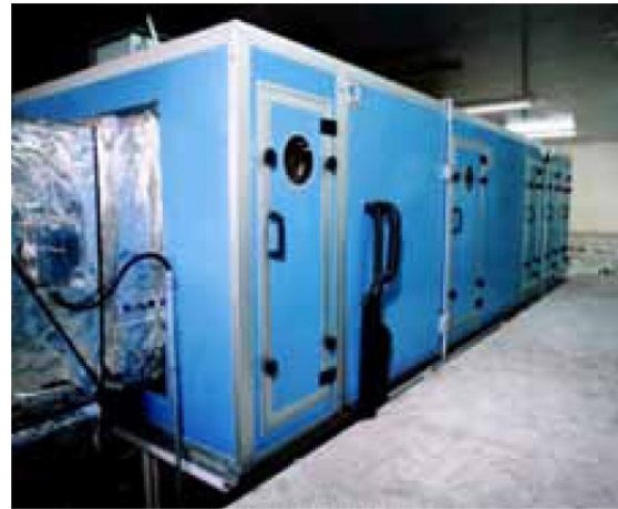
Figura 5 - Sistema de Tratamento de ar
